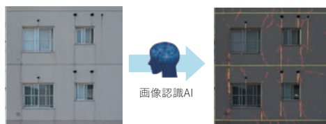
画像認識AIによるひび割れ自動検出の例
